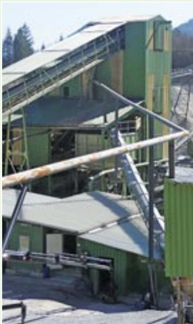
Sand- & Kieswaschanlage in Österreich Schlammablaufleitung zur Pumpenstation
